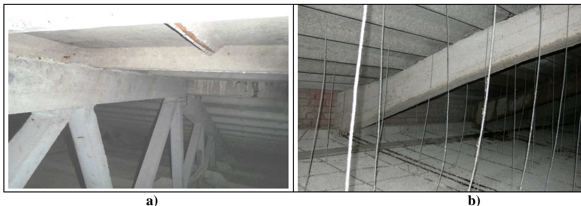
Obrázek 1. Použití nevhodných prvků ve vodárenství
